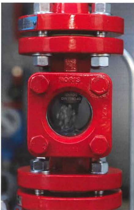
Puffercontainer: Durchfluss Schauglas vor Pumpen
