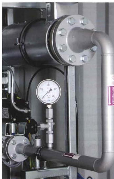
Puffercontainer: Ausgang Ammoniak
